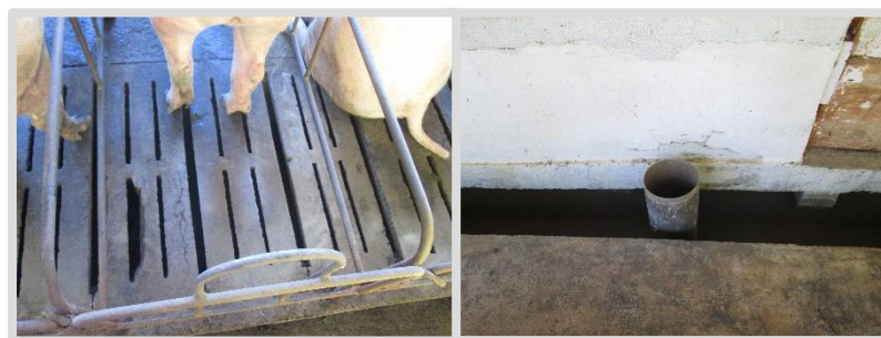
Figura 9 - Sistemas de fossas internas, abaixo do piso do animal
